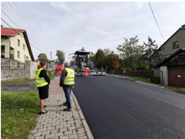
Wójt Istebnej oraz przedstawiciel firmy Strabag podczas wizytacji na remontowanym odcinku DW 941 | fot. arch. UG Istebna
