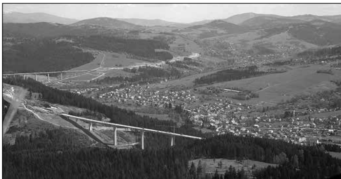
Budowa drogi ekspresowej na Słowacji (Dálnice D3), do której projekt nawiązuje. Najbliższe zjazdy znajdują się w gminach Svrčinovec i Skalité.
