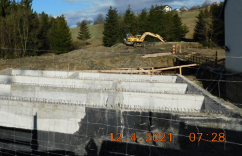
Oczyszczalnia ścieków Pustki | fot. Edyta Kukuczka
