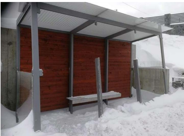
Fot. Aleksandra Kukuczka | Zniszczone szyby przystanku autobusowego
