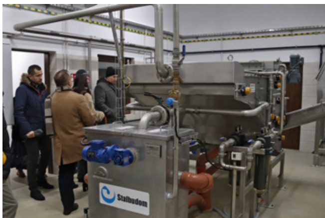
Wnętrze zmodernizowanej oczyszczalni ścieków w Istebnej-Glinianym | fot. Jacek Kohut
